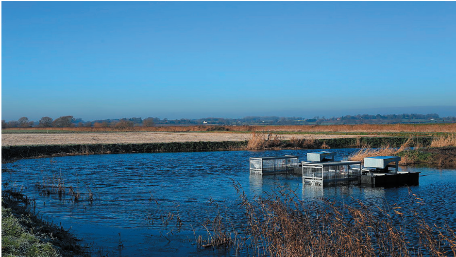
Bij dit waterreservoir wordt het water opgeslagen via een pompstation. Foto: FRESH4Cs
